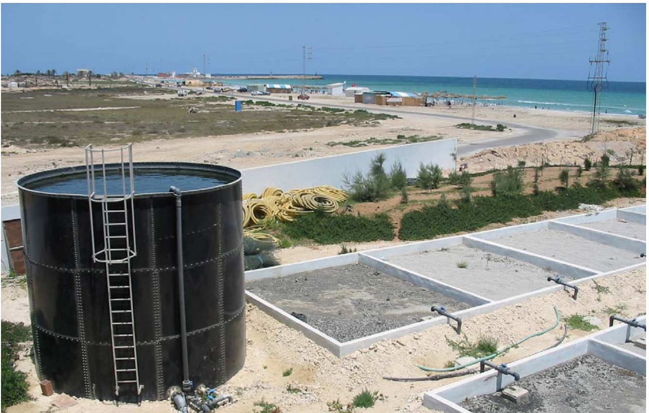
Silo à boues et lits de séchage
