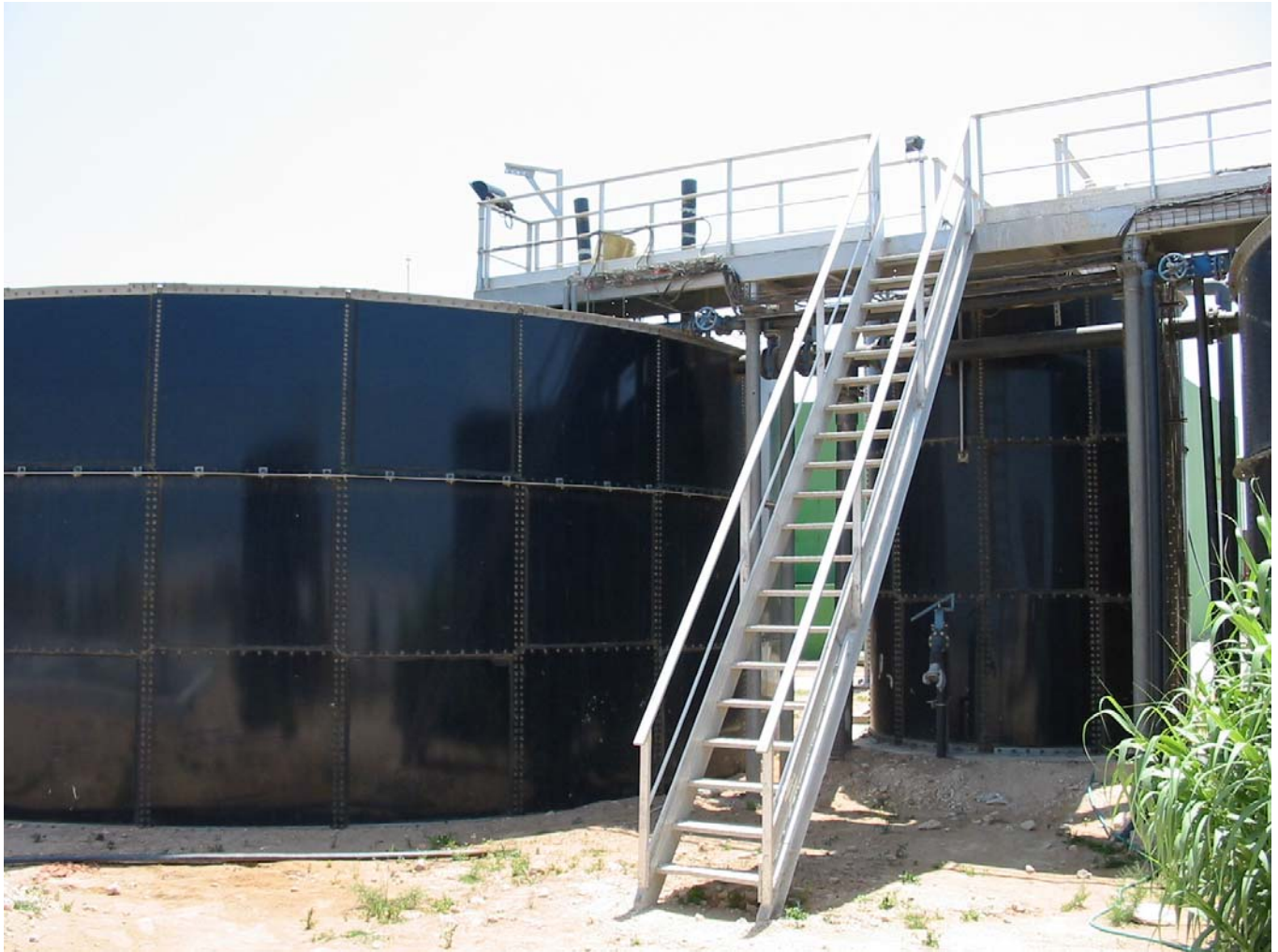
Bassins en acier vitrifié de la station d'épuration du club Méditerranée à BEKALTA.
