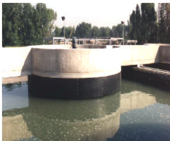
Bassin en béton avec turbine protégée par sa « jupe » en béton / Reinforced tank with its turbine protected by a Concrete « skirt »
